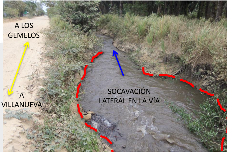
SOCAVACIÓN MARGEN DERECHA DE LA VÍA
