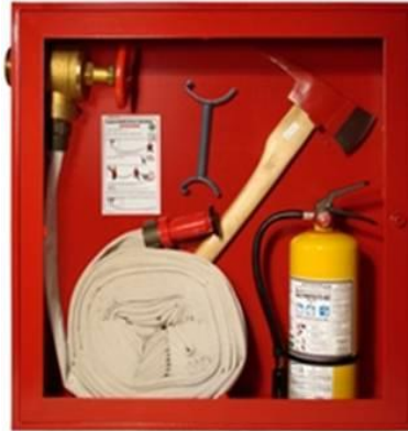
Imagen del sistema de gabinetes contra incendio del CAD
