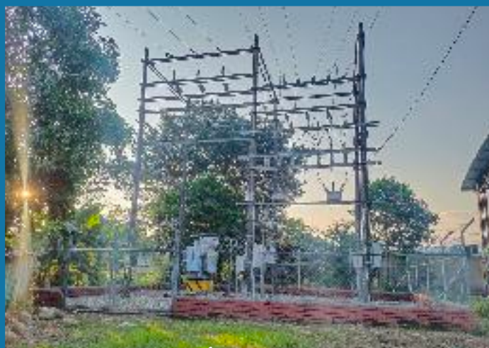
SUBESTACIÓN LAS AMERICAS
