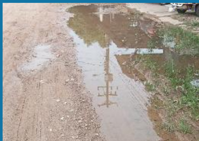
AUSENCIA DE ALCANTARILLADO
