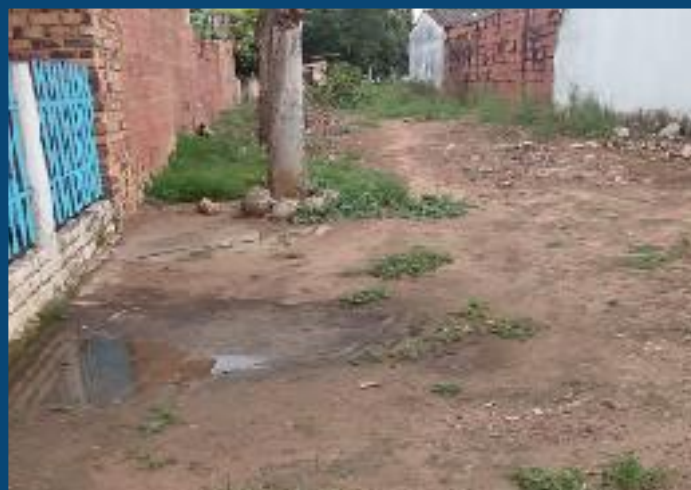
MAL ESTADO DE VÍAS
